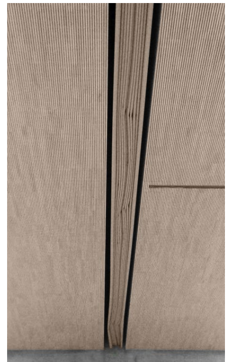
Trennwand hochgefahren in Nische
