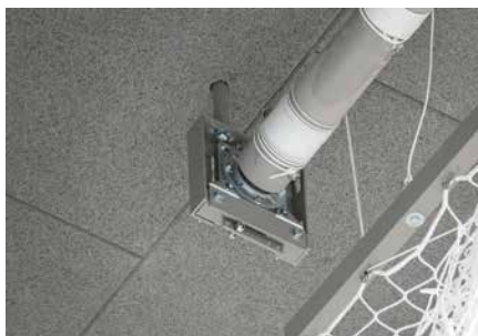
Antriebswelle lagerseitig (Abrollsicherung)
