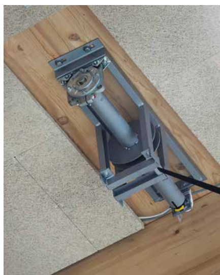
Moteur sur le côté gauche
